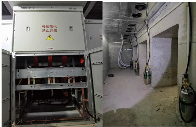
国网临邑梨城110kv变电站（电气柜式）▶
